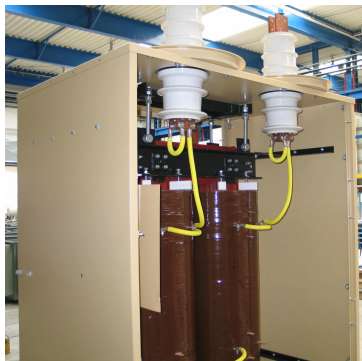
Transformator jednofazowy do wzbudzenia generatora 1350kVA na napięcie 22kV
