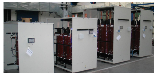
Transformatory w obudowach IP20 z wyprowadzonymi szynami DN na górę transformatora do mostów szynowych.
