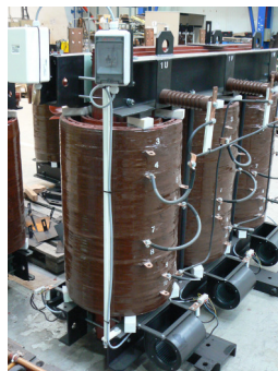
Transformator 630kVA o przekładni 15/0,4kV z układem chłodzenia AF.
